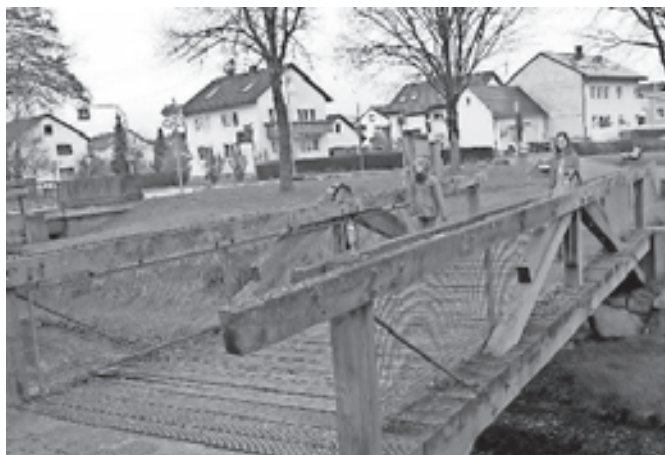
In einem schlechten Zustand sind die Bachbrücken am Mühlbach und Neugraben. Jetzt sollen sie erneuert werden.
