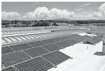
Grüne Produktion bei SensoPart Gottenheim, 31. August 2017 – Die Einweihung von SensoParts neuer Produktionshalle steht noch aus, aber die Photovoltaikanlage auf dem Dach liefert schon seit einer ganzen Weile erneuerbaren Strom. Auch sonst legt der Sensor
