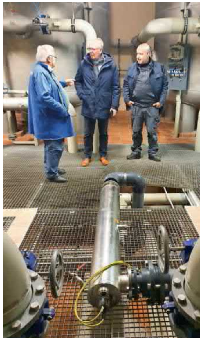
Im Vordergrund die UV-Anlage
