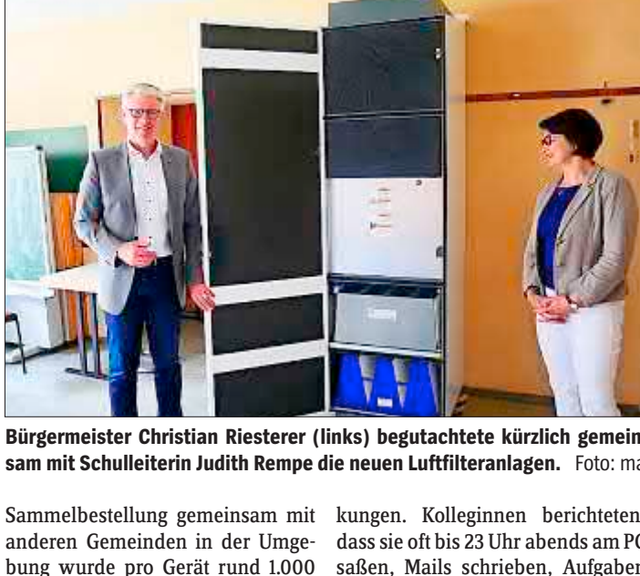
Bürgermeister Christian Riesterer (links) begutachtete kürzlich gemeinsam mit Schulleiterin Judith Rempe die neuen Luftfilteranlagen. Foto: ma
