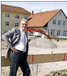
Halbzeit – und noch viel zu tun. Bürgermeister Riesterer vor der Baustelle für den neuen Kindergarten. Foto: ma
