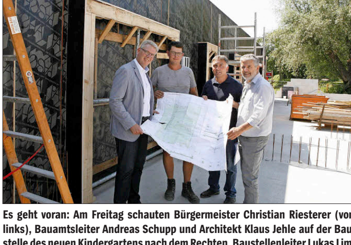
Es geht voran: Am Freitag schauten Bürgermeister Christian Riesterer (von links), Bauamtsleiter Andreas Schupp und Architekt Klaus Jehle auf der Baustelle des neuen Kindergartens nach dem Rechten. Baustellenleiter Lukas Limberger (2. von links) erklärte die nächsten Bauschritte.
